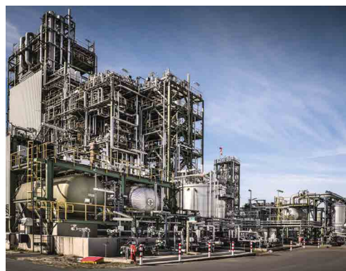
Usine pilote sur un site de TotalEnergies à Dunkerque © Dominique Fontenat
